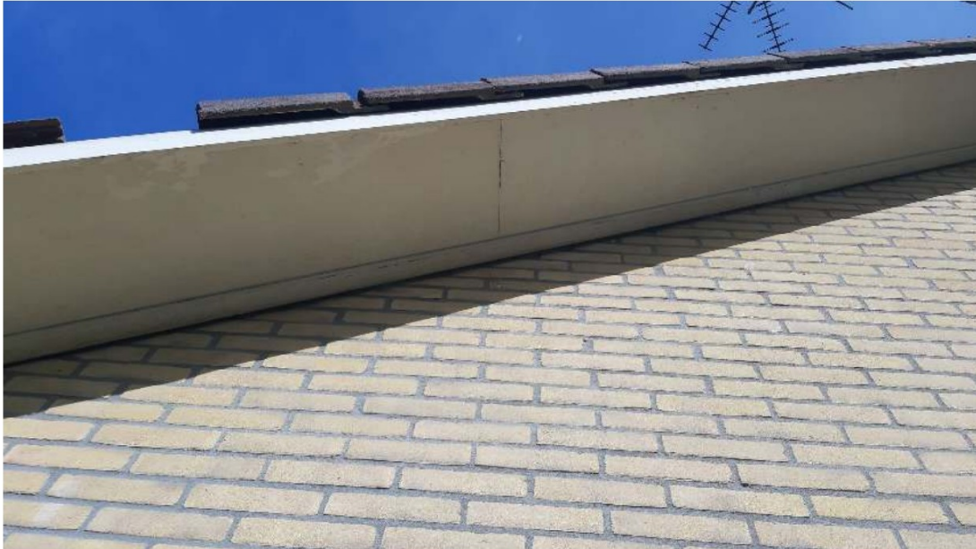
Afbeelding 10: Missende dakpan en ruimte tussen de muur en boeidelen.
