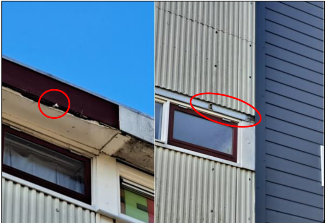
Figuur 4.2: aangetroffen nestplaatsen van huismus in het projectgebied in gaten in boeidelen en kieren en openingen achter de gevelbekleding. Bron: Ecogroen.
