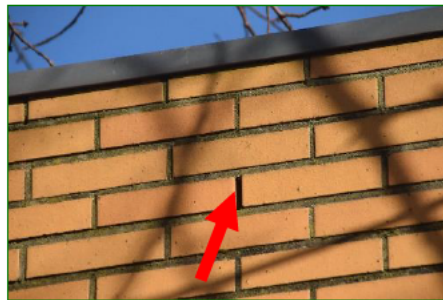
Open stootvoeg voorzijde van gebouw.
