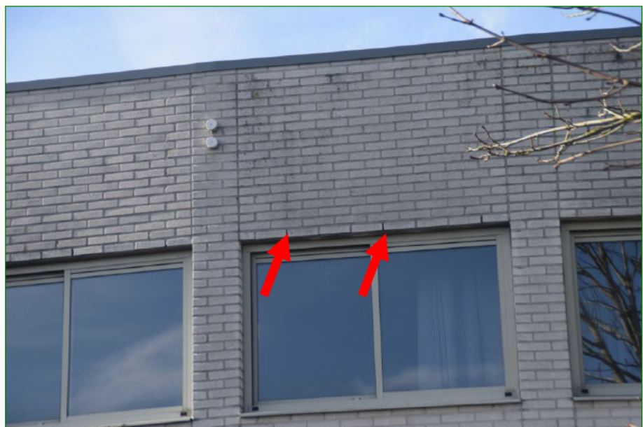
Open stootvoegen op eerste verdieping aan de achterzijde van het gebouw.
