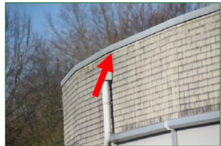
Kier bij dakrand.
