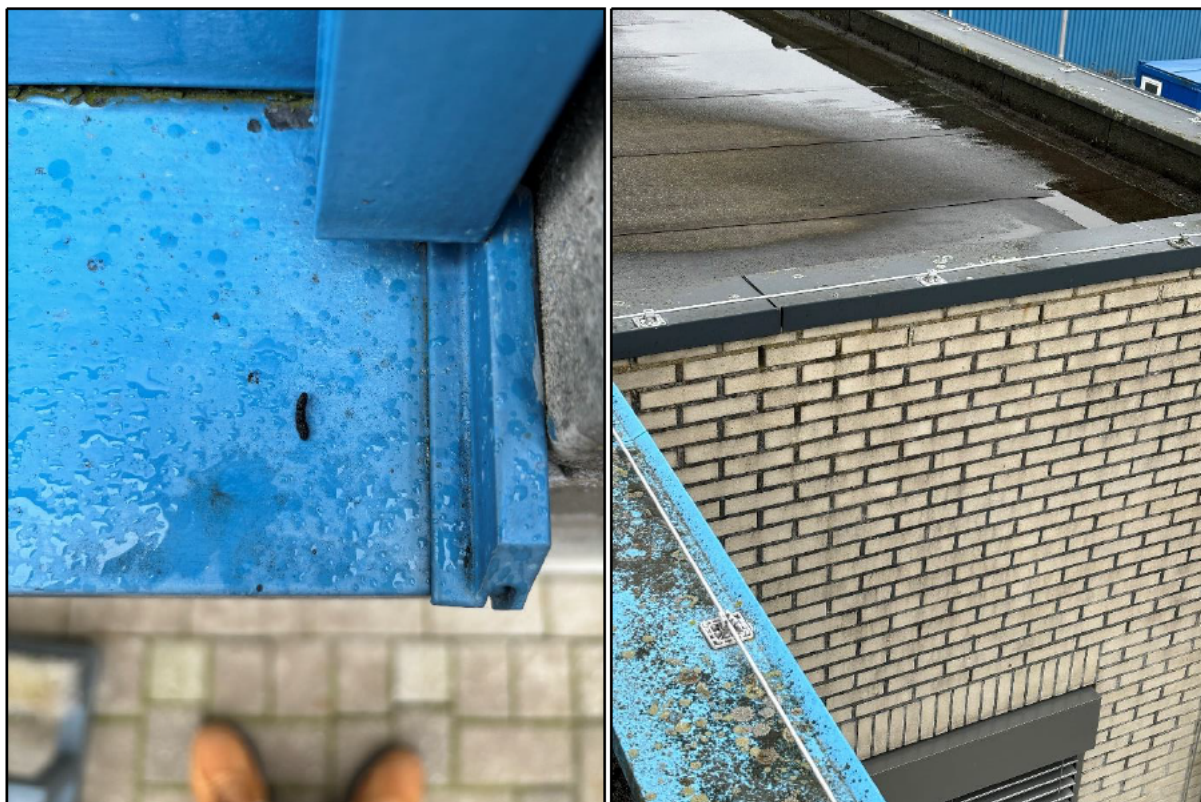
Figuur 5 en 6: Uitwerpsel van een vleermuis op een van de waterslagen aan de zuidzijde van het gebouw (links) en open stootvoegen en opstaande dakrand (rechts).
