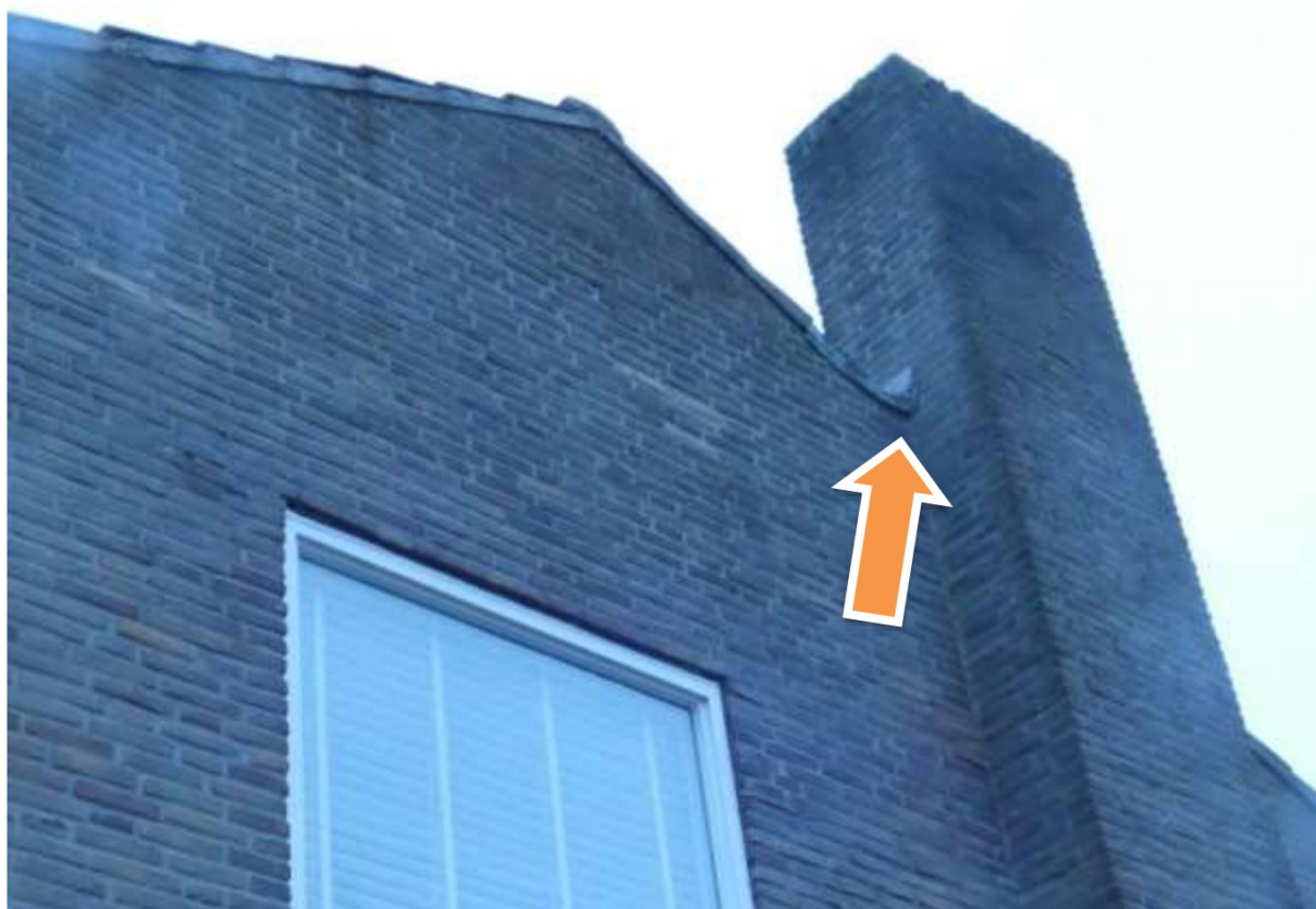
Figuur 4.3 Openingen onder loshangende loodslab, geschikt voor toegang tot verblijfplaats vleermuizen.
