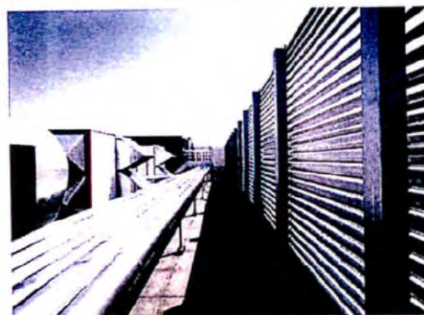
schil rondom installaties
