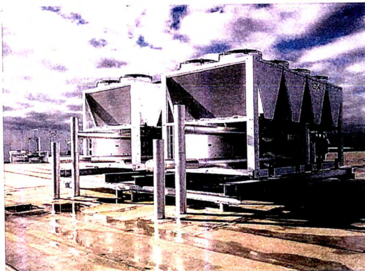
installaties in een lichtgrijze kleur gecoat
