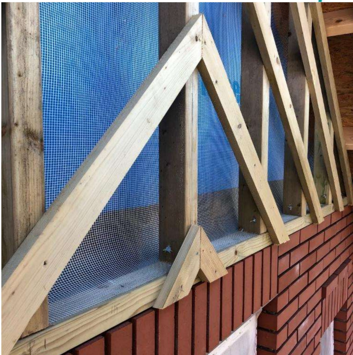
Figuur 5.2 Een voorbeeld van een vlemuisvoorziening achter gevelbetimmering, waarbij fijn kunststofgaas is toegepast voor grip (bron: Arcadis).
