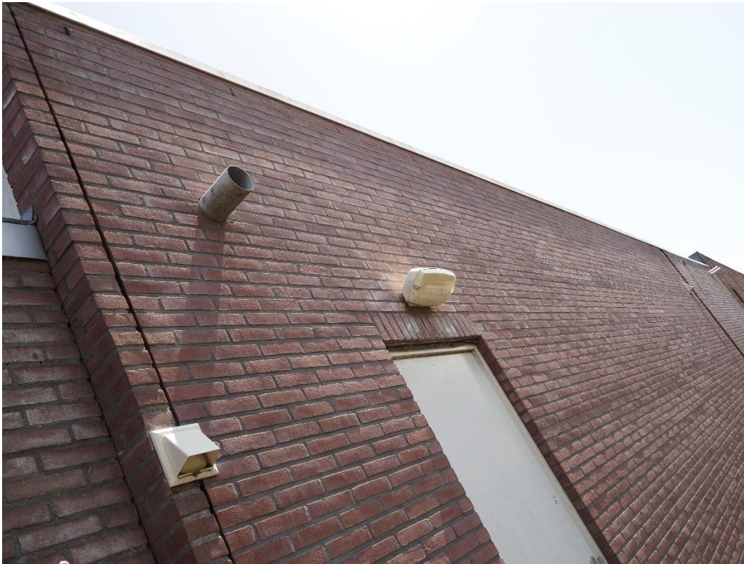
Figuur 8: in de steeg aan de westkant bevinden zich open stootvoegen en op een enkele plek een licht open staande daktrim, waardoor de gewone dwergvleermuis en de ruige dwergvleermuis naar binnen kunnen kruipen.
