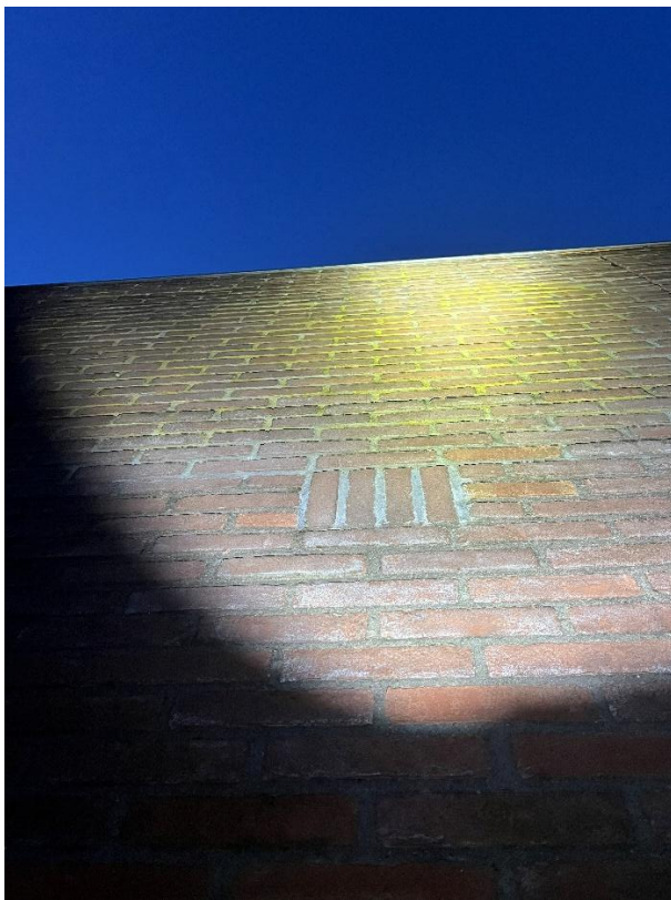
Figuur 9: de licht openstaande daktrim in de steeg waar de gewone dwergvleermuizen in vlogen.
