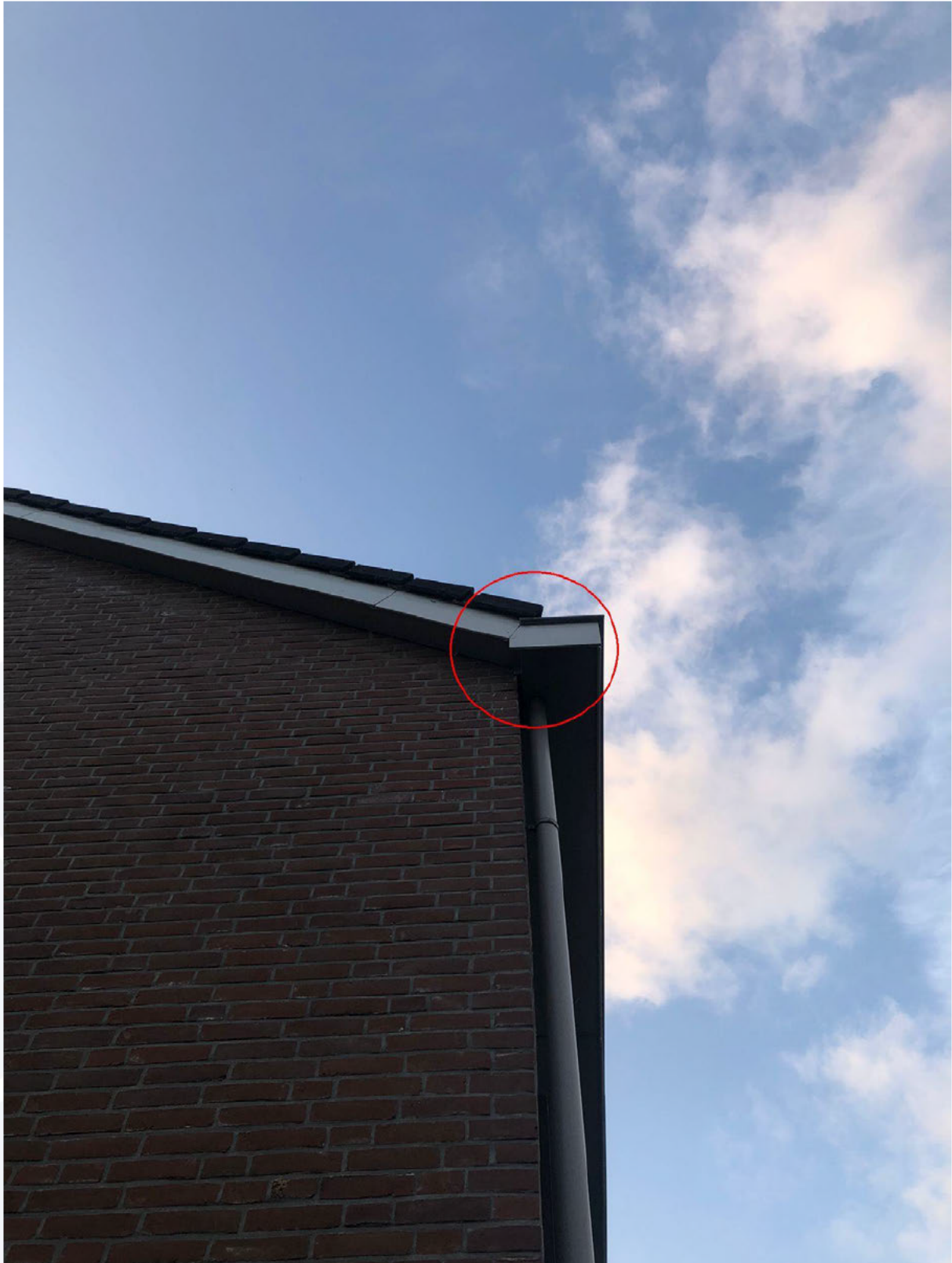
Verblijfplaats de Morinel 296 tussen dakoverstek en muur.
