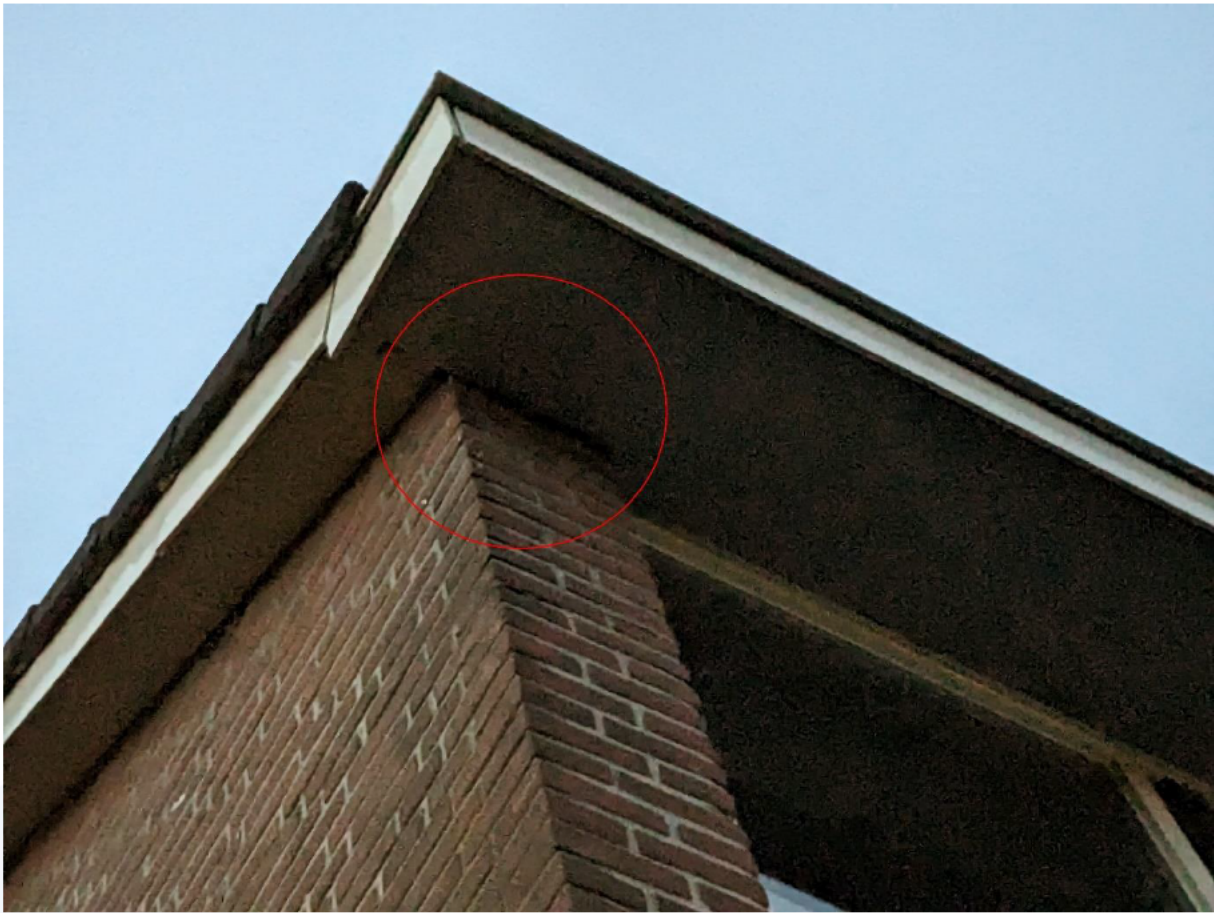
Verblijfplaats de Morinel 258 tussen dakoverstek en muur.
