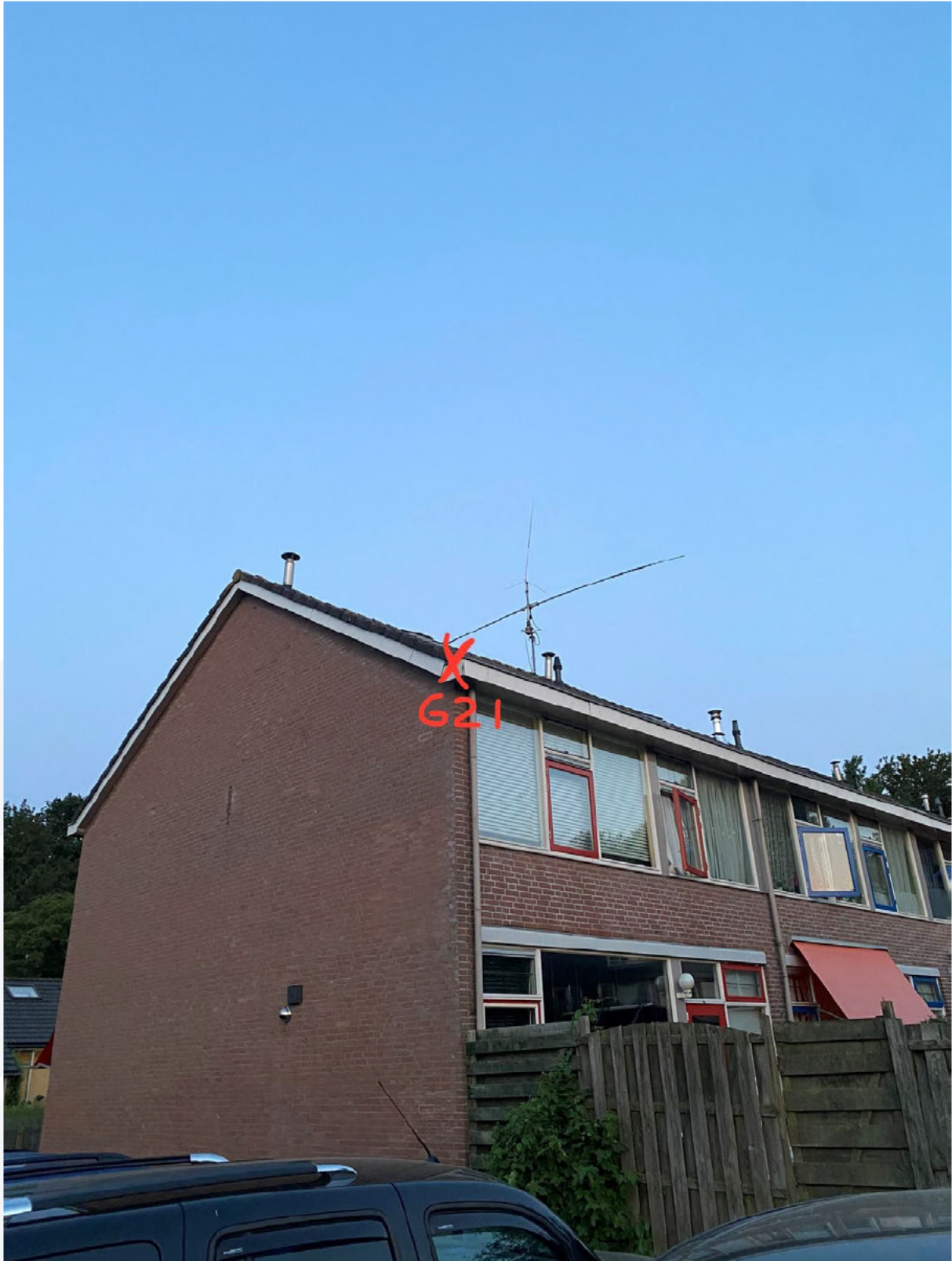
Verblijfplaats de Morinel 304 tussen onder dakpan.
